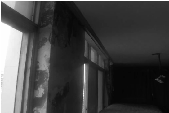
外墙粉刷层脱落(a)
