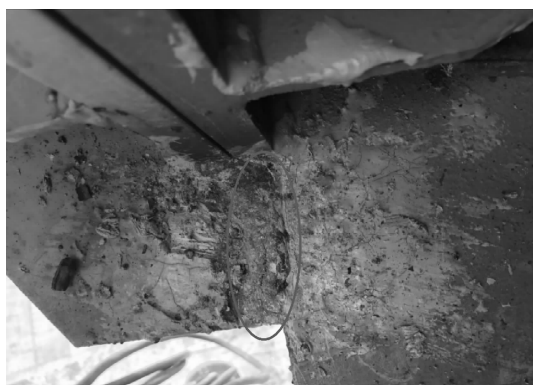
图 6 过跨期间主梁与导梁结点焊缝开裂
