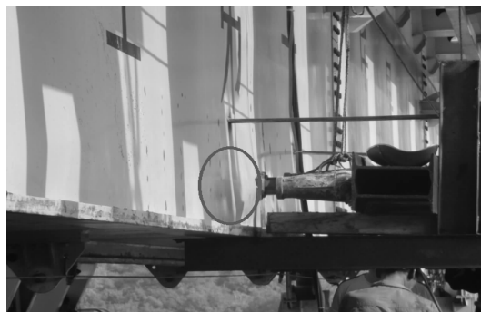
图 7 主梁下部非过跨主受力区域的变形状况
