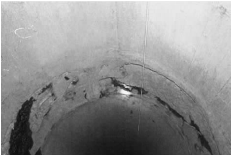
图2 施工环缝漏水
