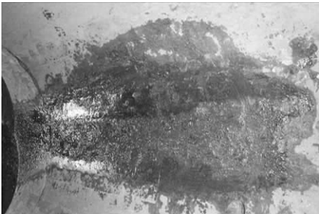
图1 蜂窝麻面漏水
