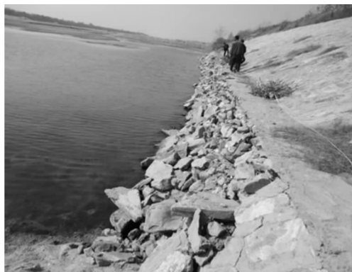
图1 护砌段坡脚水毁图
